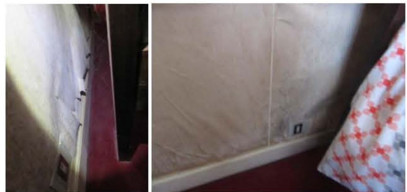
Papier-peint en mauvais état derrière le lit, contaminé par les moisissures
